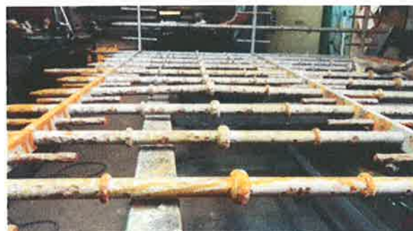
Stav plotu severní branky po dokonalém očištění až na kov – po nátěru bezoplachovým odrezovačem s Taninem
