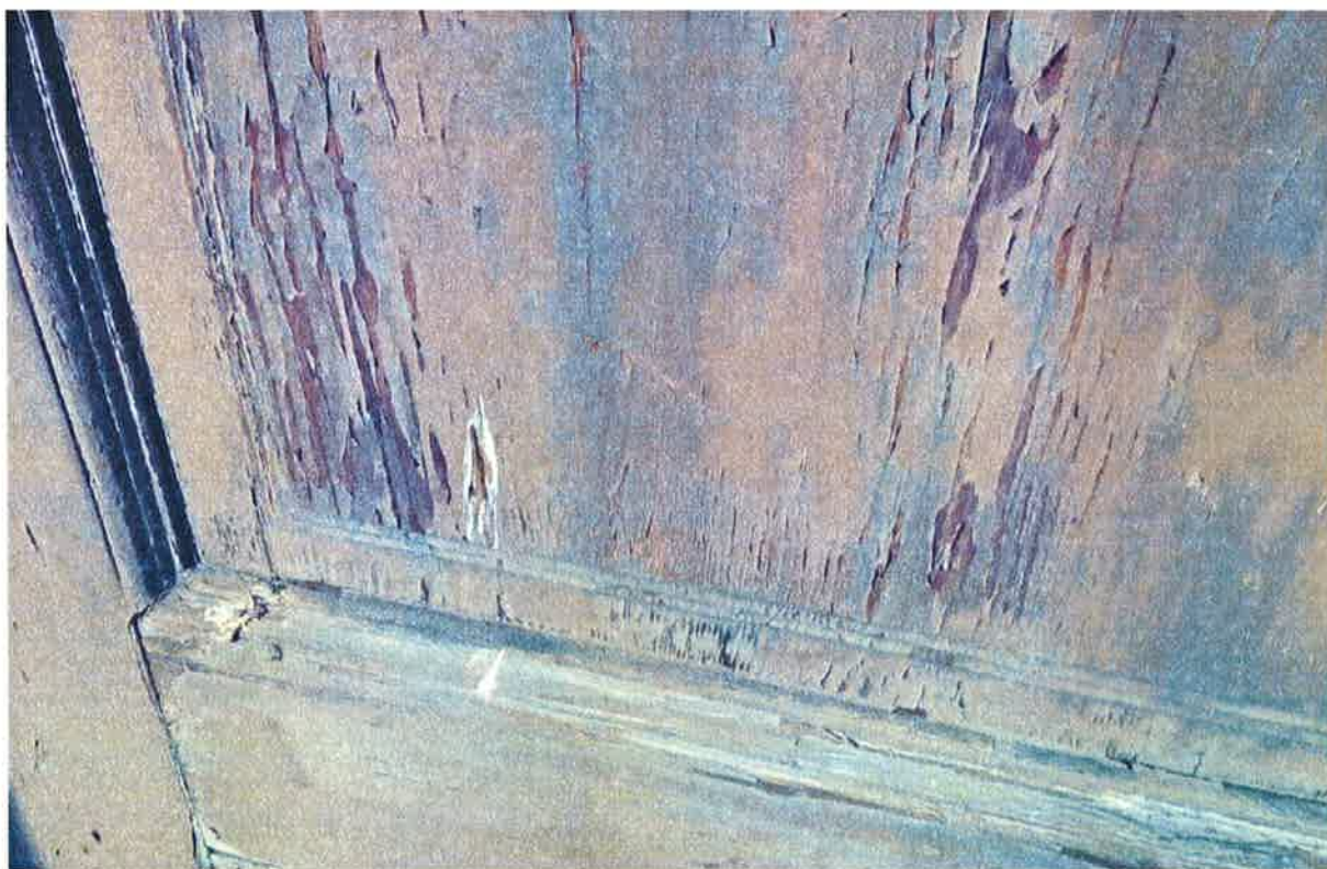
Stav před restaurováním
