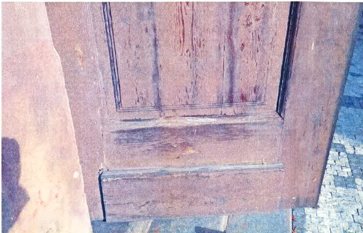
Stav před restaurováním
